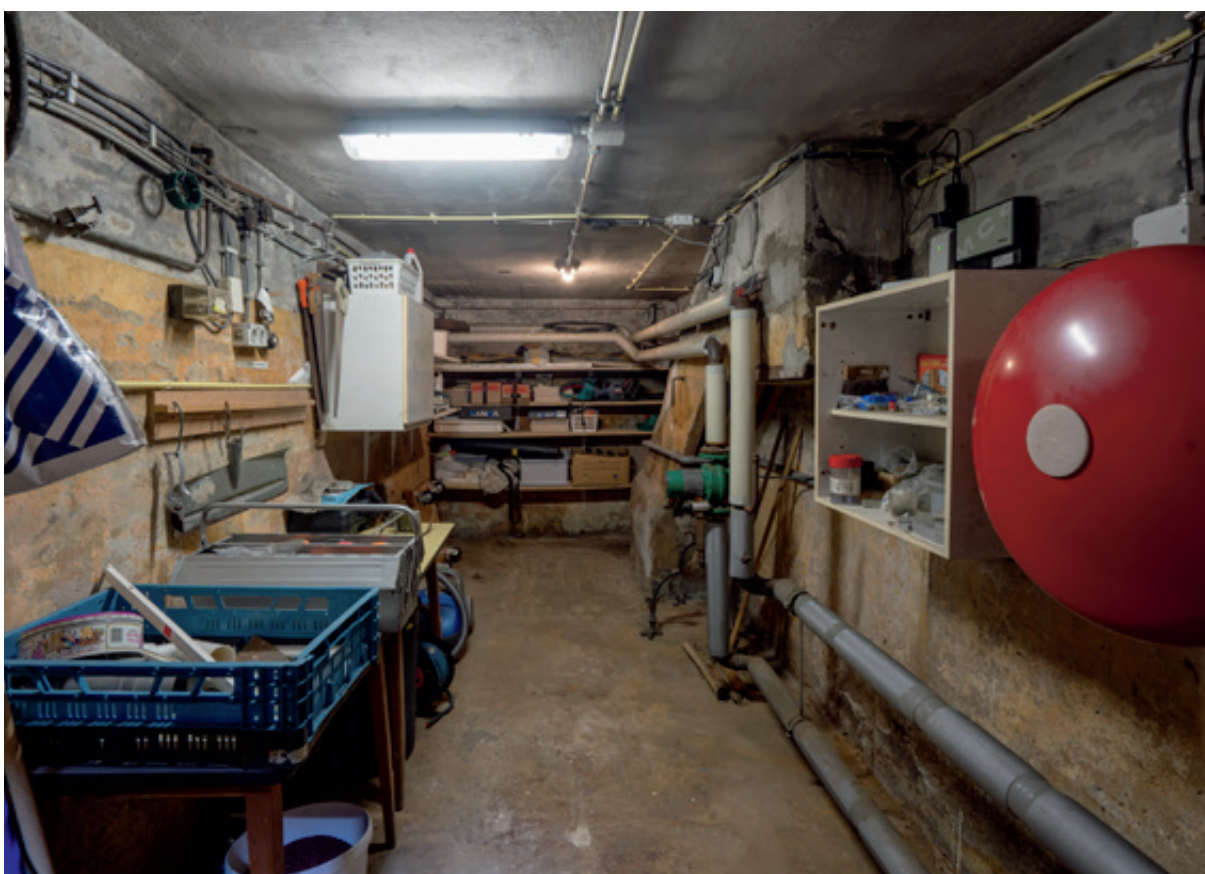
Kelder- en cv-ruimte
