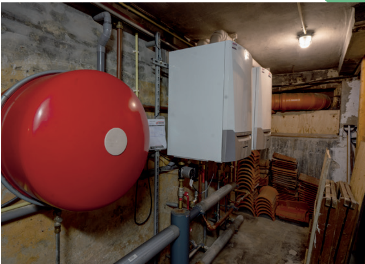
Kelder- en cv-ruimte
